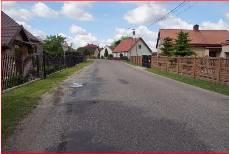
Nawierzchnia przed remontem
